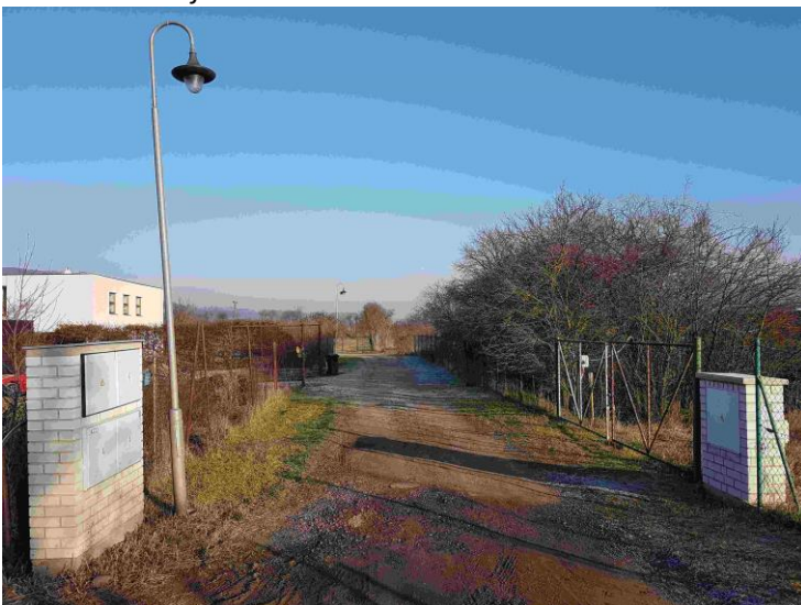
Obr. 6: Havarijní stav místní komunikace K Vodárnám
