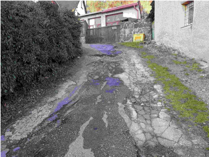
Obr. 5: Havarijní stav místní komunikace Příkrá
