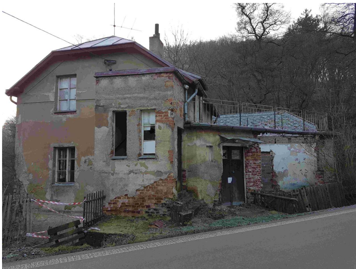
Obr. 13: Budova rozpadlého bývalého mlýna
